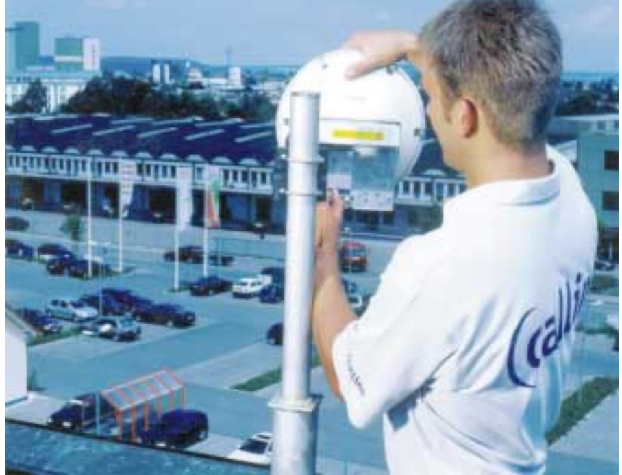
Mit dieser nur ca. 25 cm großen Antenne erhält der Callino-Kunde über die WLL-PMP-Technik seinen High-speed-Zugang zum Internet; da die Daten per Richtfunk zur Basisstation übertragen werden, müssen die Antennen genau aufeinander ausgerichtet werden (Foto: Callino)
